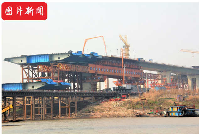
12月29日, 沌口滩区引桥最后一跨移动模架现浇箱梁顺利浇筑。
