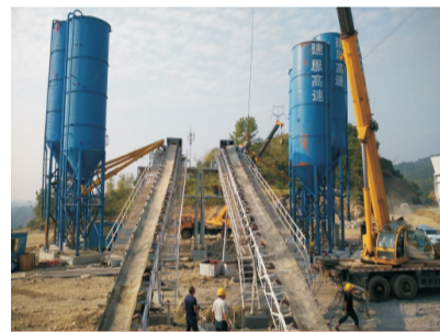
建设中的1#砼拌合站
